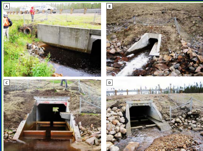
Figure 2. Quatre types de passages fauniques conçus pour les mammifères de petite et de moyenne taille le long de la route 175: (a) ponceau sec (PS) ou tuyau circulaire (n = 6); (b) ponceau avec tablette de bois installée en porte-à-faux (PTBois) (n = 4); (c) ponceau avec pied sec de type tablette de béton (PTBét) (n = 7); (d) ponceau avec banquettes de béton (PBBét) (n = 1).
